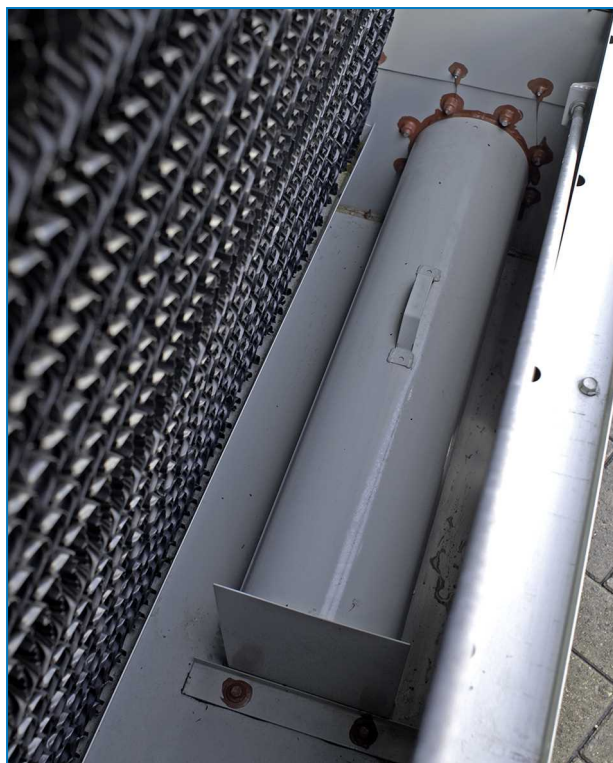
Бассейн холодной воды и сетчатый фильтр бассейна
