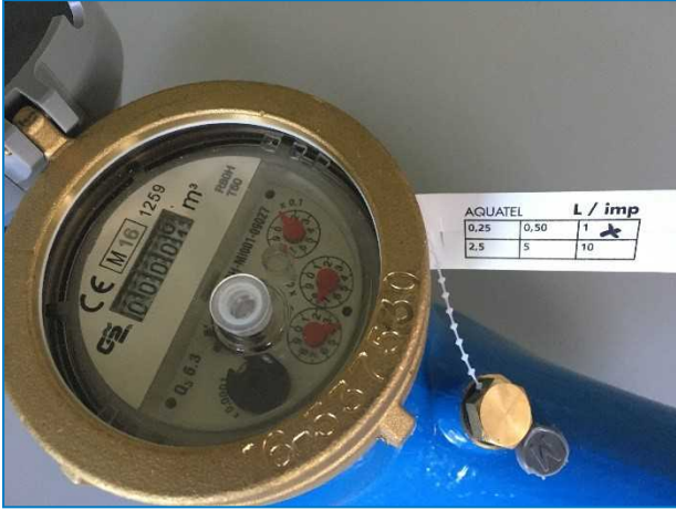
Water meter (Medidor de agua)
