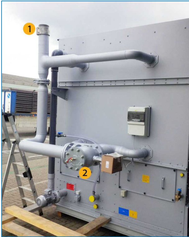
Unità con tubazione esterna chiusa
